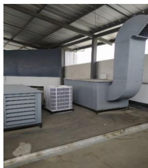
Puesta en marcha de los sistemas de climatización y absorción
