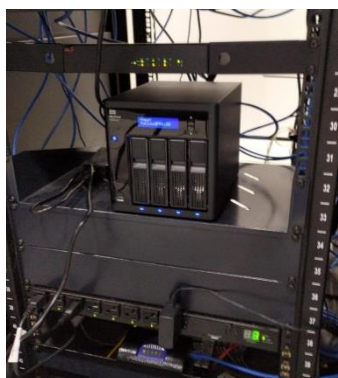
Estación de almacenamiento para el Laboratorio de Informática Forense
