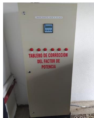
Puesta en marcha de banco de capacitores
